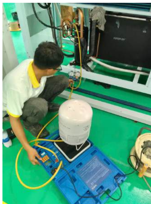
BẢO TRÌ BẢO DƯỠNG CHILLER CHILLER MAINTENANCE
